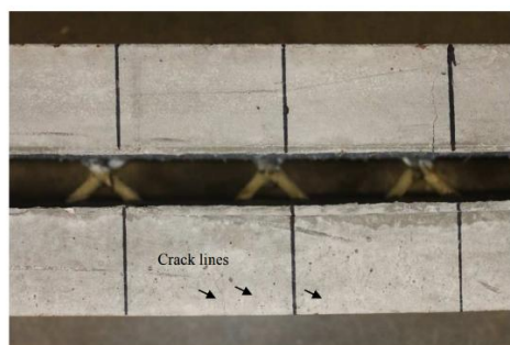
شکل ۳- ترک های متعدد در سطح پایینی DSF
